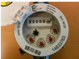
Wasserzähler mit Plastabdeckung
