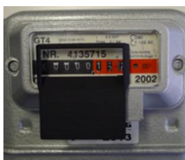
FAST Gas Meter Adapter Frame auf einem Gaszähler
